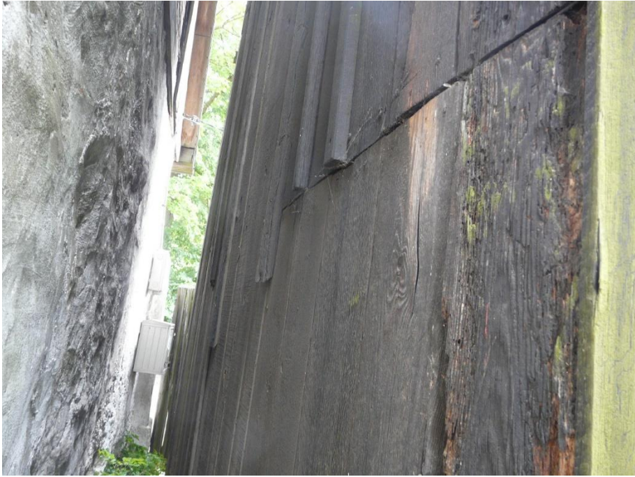
Elewacja wschodnia. Widoczne naprawy oraz silnie zniszczoną deskę na skutek działania wody.
