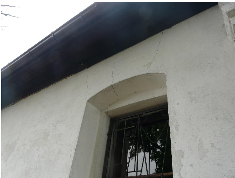
Spękania nad oknem na elewacji południowej
