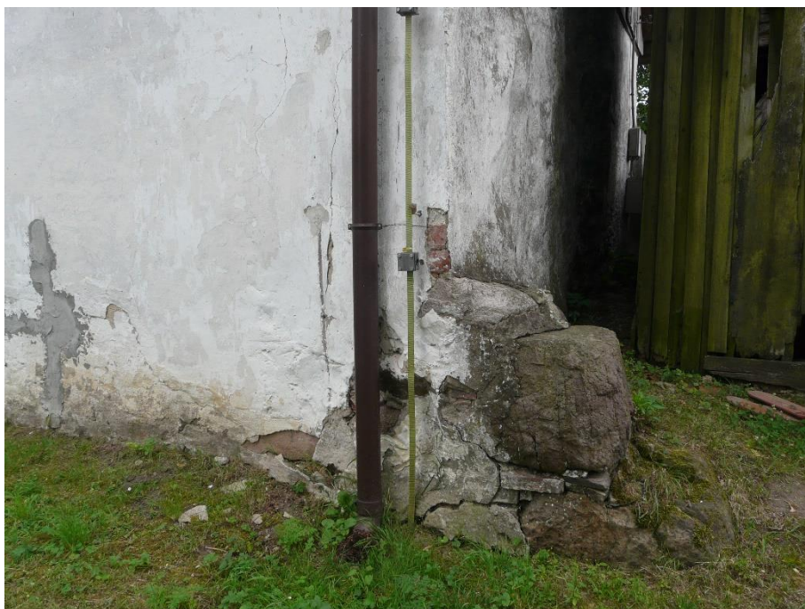
Spękania widoczna na narożniku północno- zachodnim. Zabrudzona powierzchnia.
