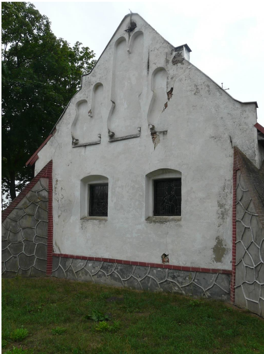
Elewacja wschodnia. Widoczne spękania oraz wypłukaną powierzchnię elewacji przy przyporach.
