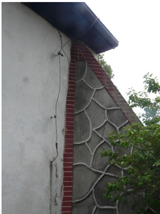
Spękanie ściany przy szkarpie na elewacji południowej.
