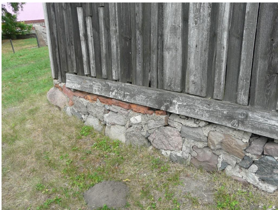
Elewacja zachodnia. Znaczne ubytki w zaprawie wiążącej kamienie i cegły podmurówki. Ubytki w warstwie cegieł.
