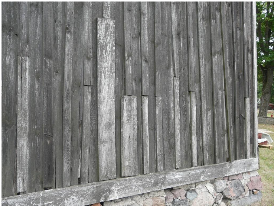
Elewacja zachodnia. Naprawy w deskowaniu elementami o odmiennych od oryginalnych wymiarach.
