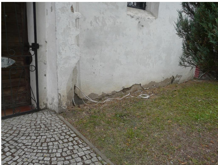
Elewacja południowa. Zniszczenia w tynku przy gruncie, wykucie na instalacje.
