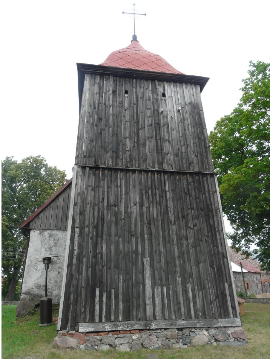
Elewacja zachodnia wieży. Widoczne naprawy w dolnej części, przebarwione, wypłukane drewno.
