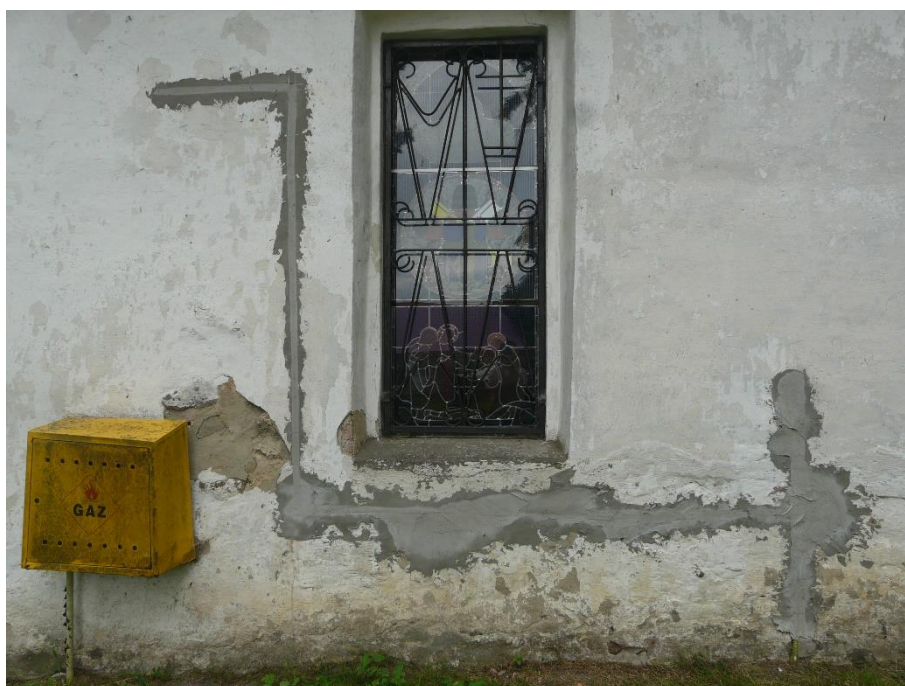
Elewacja południowa. Bruzda instalacyjna, ubytek w tynku, łuszcząca się farba na tynku.
