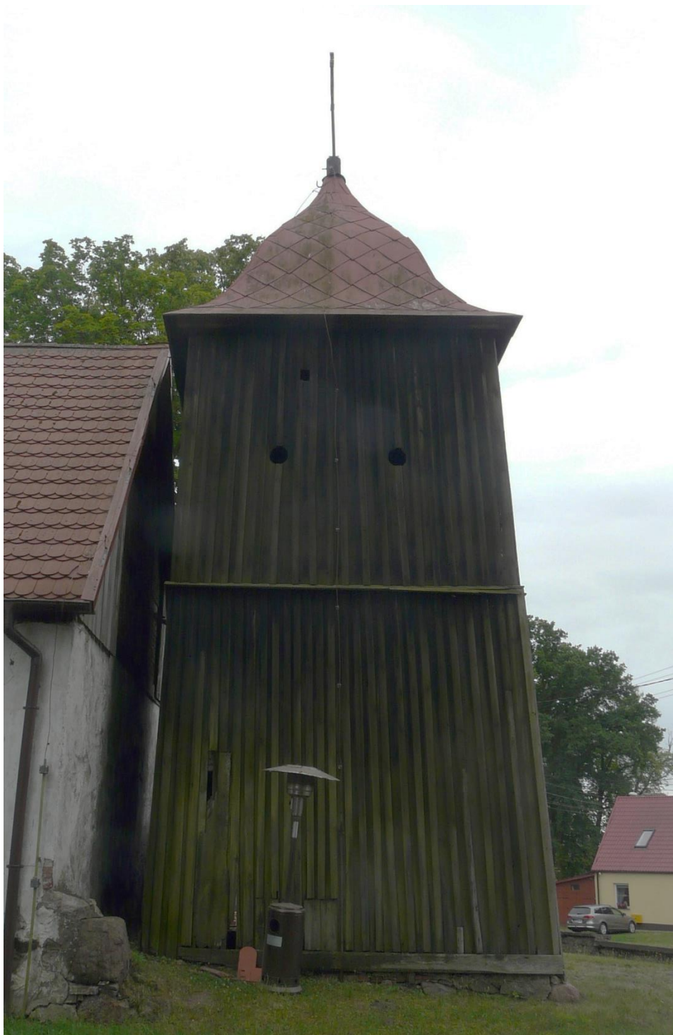
Elewacja północna. Powierzchnię drewna pokrywa nalot glonów.
