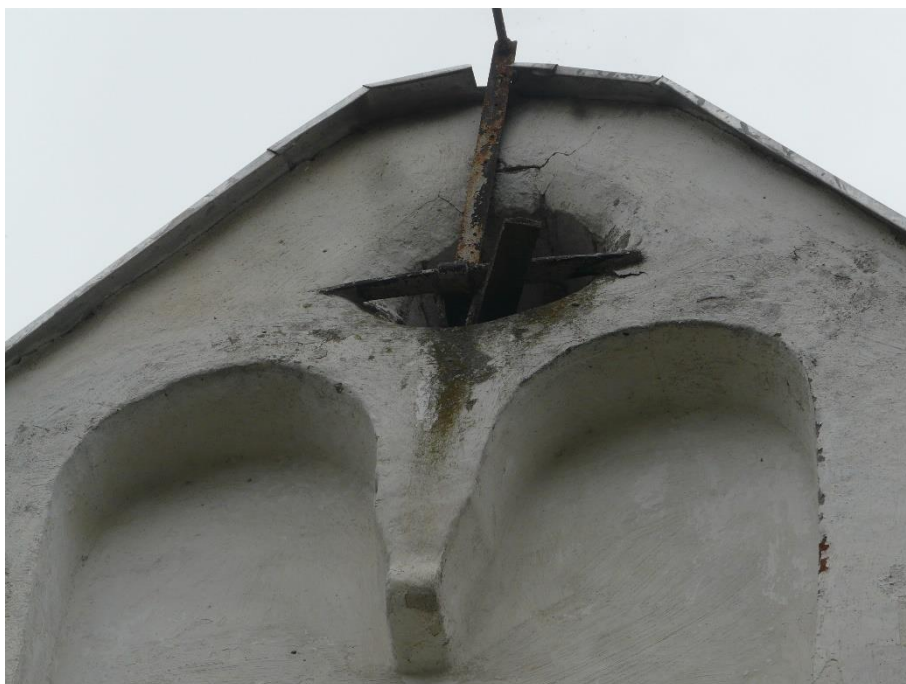
Szczyt ze spękaniami, zaciekiem pokrytym glonami i skorodowanym mocowaniem.
