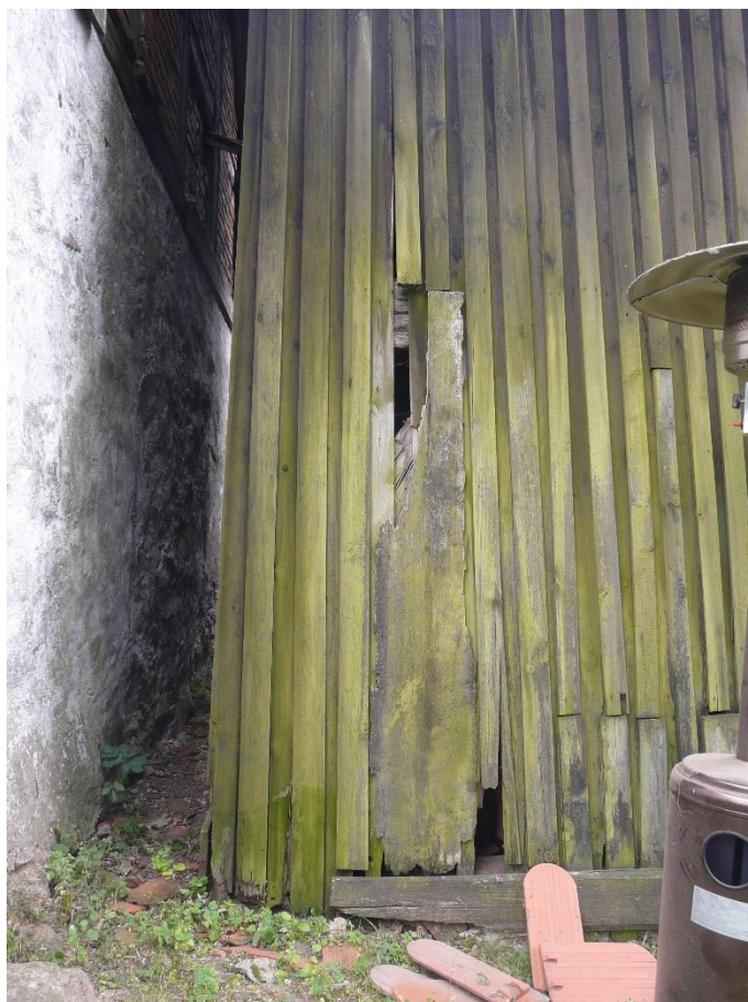
Fragment elewacji północnej z ubytkami i nieestetycznymi naprawami, drewno pokrywa nalot alg.
