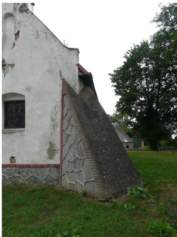
Narożnik południowo- wschodni. Spękana szkarpa pokryta nalotem porostów.
