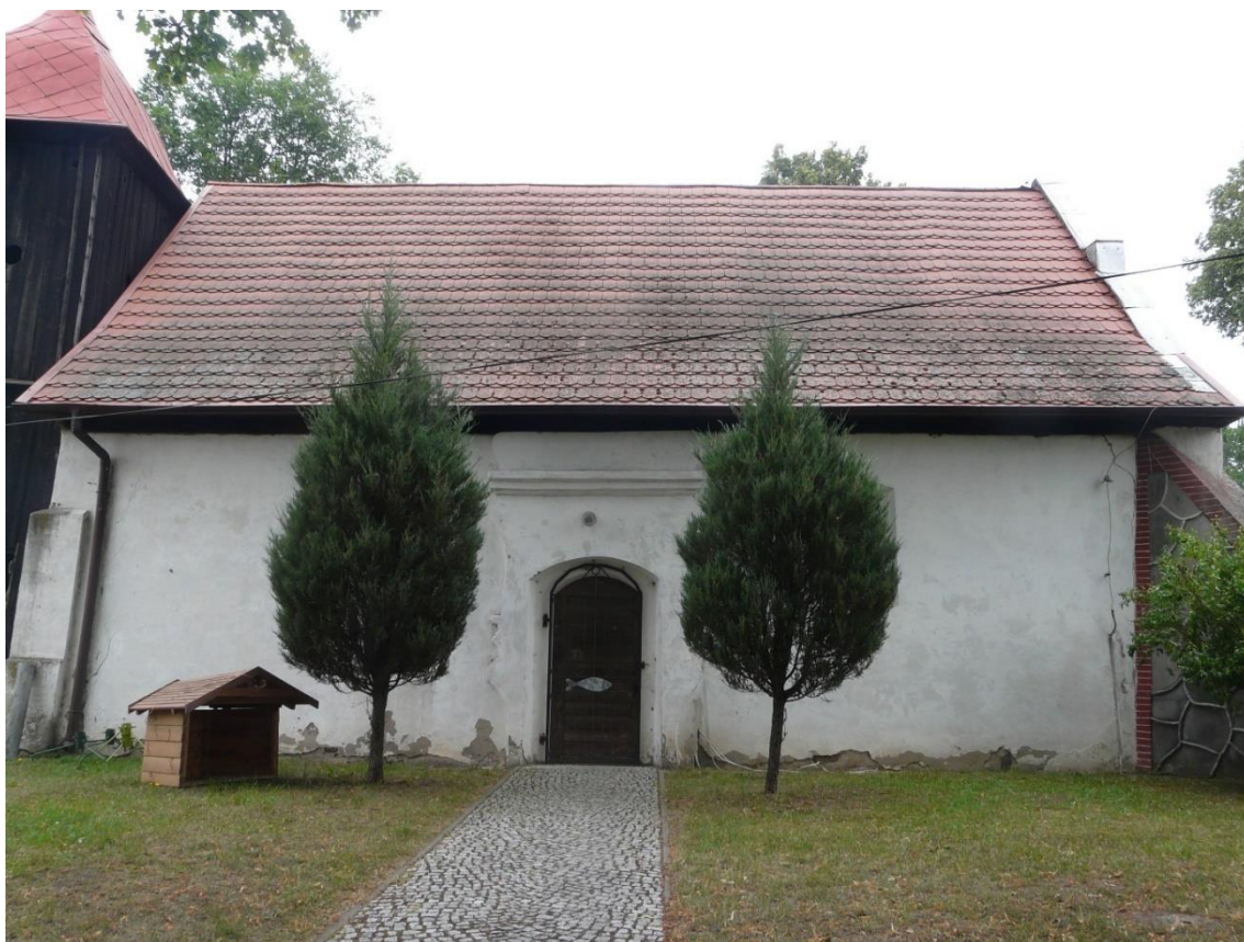
Elewacja południowa. Widoczne zawilgocenie dolnej partii, zbrudzenie powierzchni, miejscowe złuszczenia farby i ubytki w tynku.
