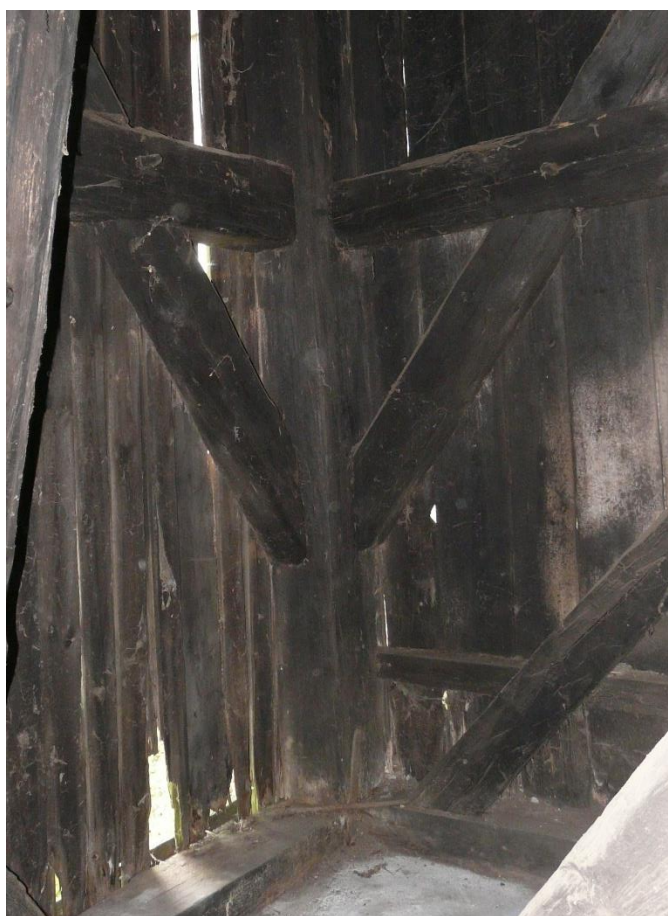
Wnętrze wieży w narożniku północno- zachodnim. Widoczne ubytki w dolnej partii desek.
