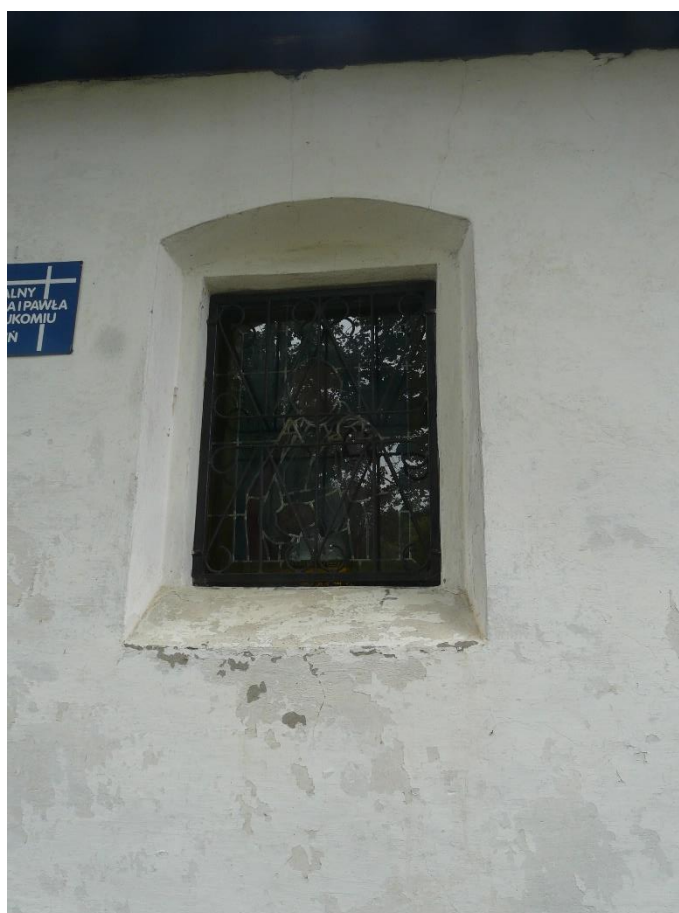
Spękanie nad i pod oknem elewacji południowej.
