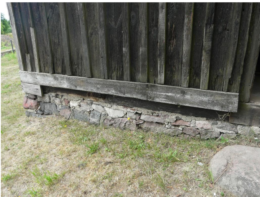
Podmurówka wieży od strony południowej. Widoczne ubytki w zaprawie.
