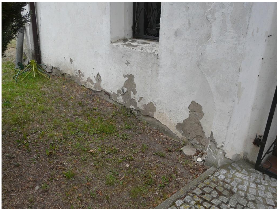
Elewacja południowa. Zawilgocenie w dolnej partii elewacji- złuszczona powłoka malarska, ubytki w tynku.
