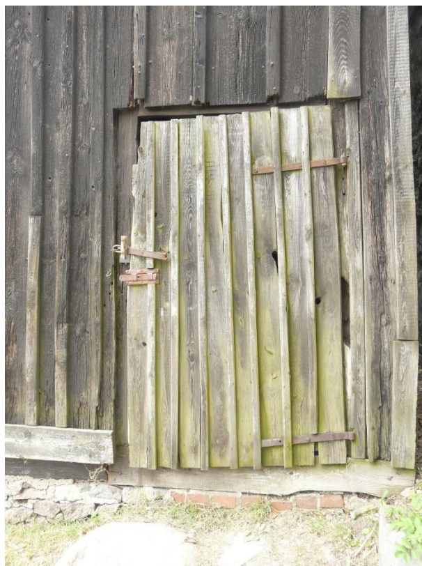
Elewacja południowa. Drzwi wtórne, wypaczone, pokryte nalotem alg. Zawiasy i zamek skorodowane.
