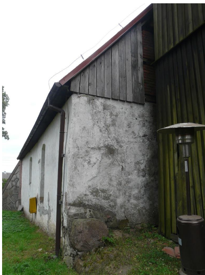
Elewacja zachodnia. Spękanie oraz ubytki w farbie.
