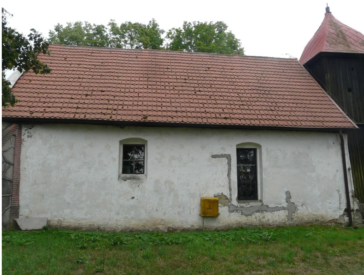
Elewacja południowa. Nieestetyczna bruza instalacyjna, zawilgocenie w partii przyziemia, ubytki w warstwie malarskiej na całej powierzchni.
