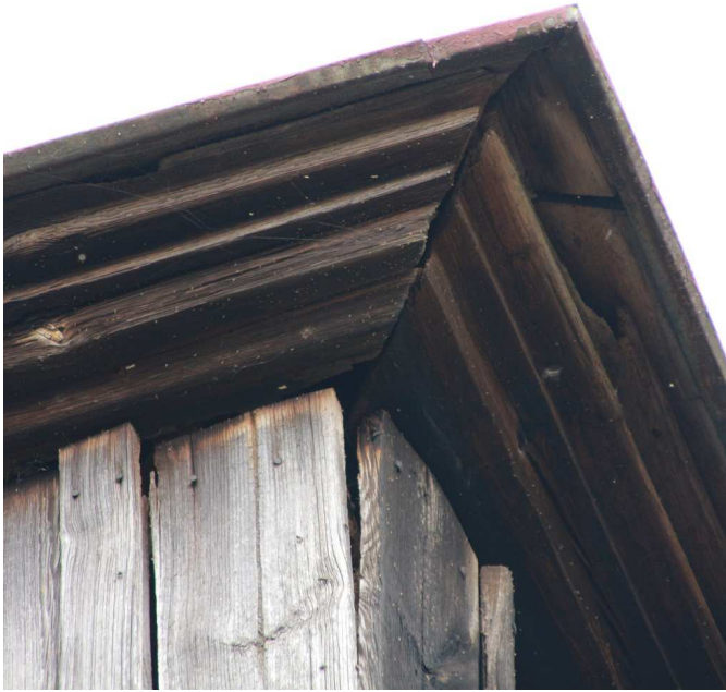
Narożnik pd-zachodni ubytek gzymsu wieńczącego
