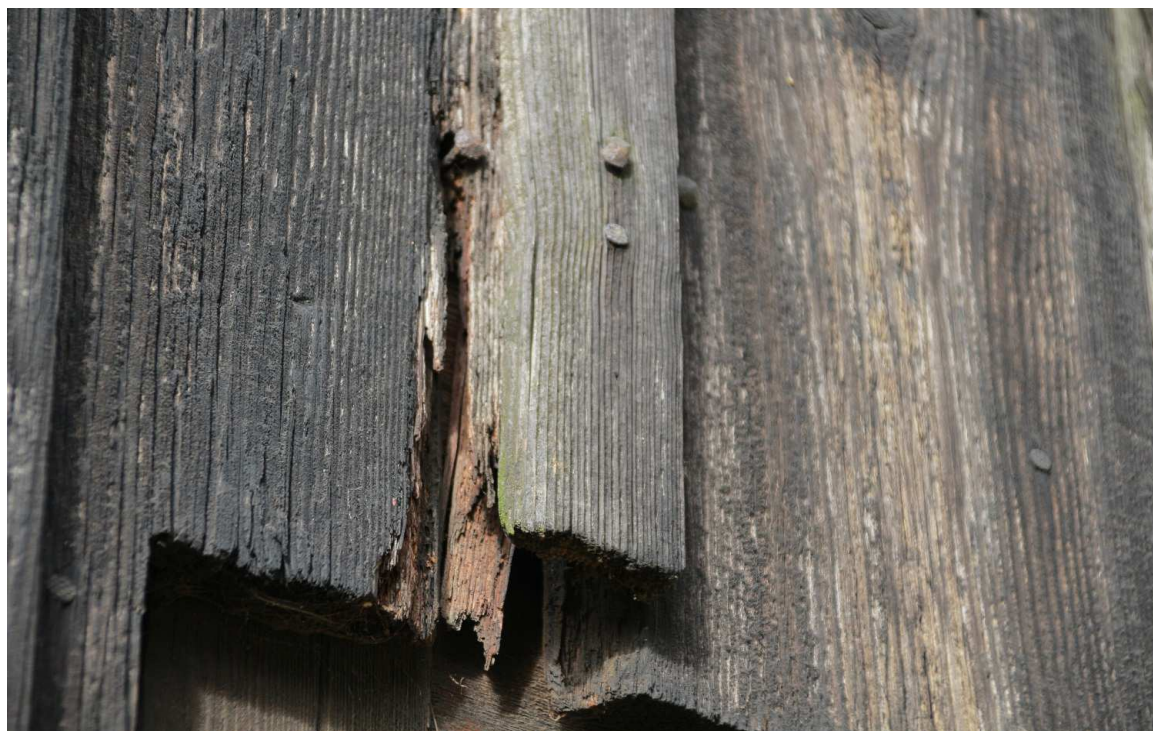
elewacja PD nad drzwiami widoczne zniszczenia, u góry gwoździe kute, poniżej współczesne
