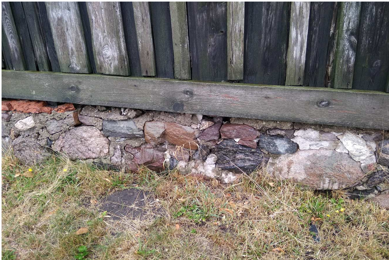
Elewacja zachodnia, zróżnicowanie i brak przewiązania materiałów podmurówki
