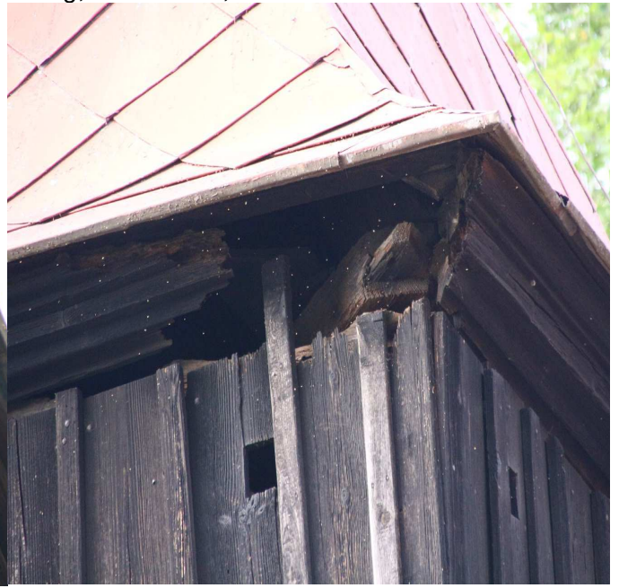
Narożnik pd-wschodni zniszczenie gzymsu wieńczącego
