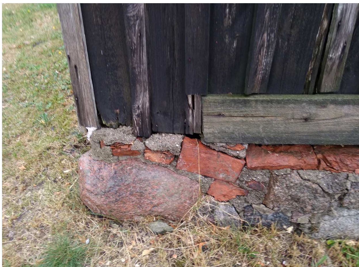
Narożnik pn-zach- wtórne uzupełnienia podmurówki pod słupem konstrukcyjnym, widoczne zniszczenia lica ceramiki oraz jej spękanie
