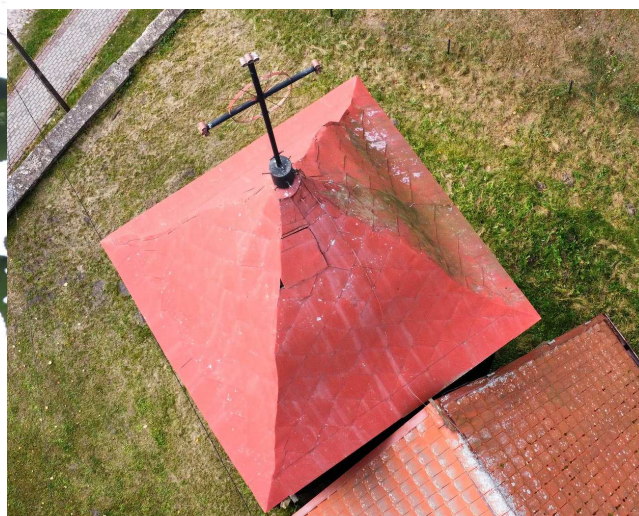
Widok od wschodu- łaty i ubytki
